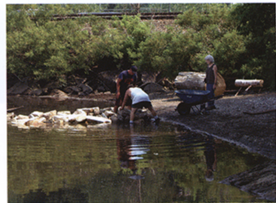
La artista y trabajadores trasladando las piedras locales y de cantera destinadas a Emergences, Riverfront Park . Río Hudson, Beacon, Nueva York, 2003
